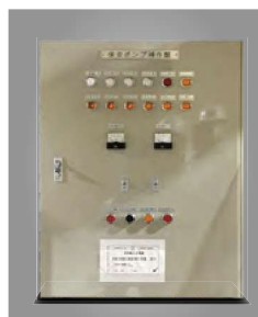
保安ポンプ操作盤
