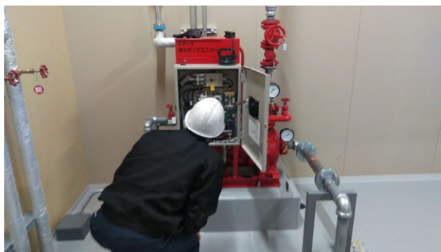
消防設備点検
